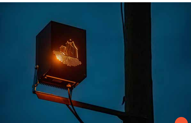
Zmodernizowana oprawa oświetlenia zewnętrznego kościoła
